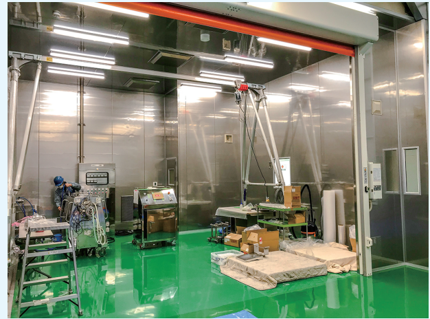
クリーンルーム内部
